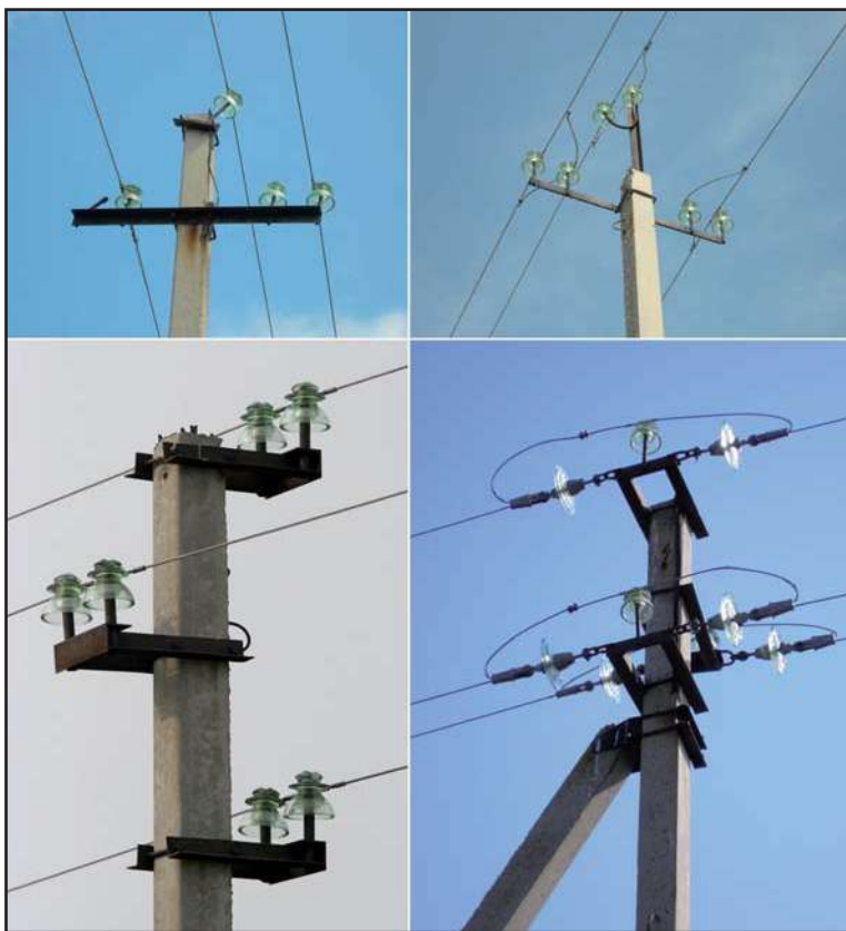
Птицеопасные ЛЭП среднего напряжения на исследуемой территории. Арыкты. Фото У. Лаш.
