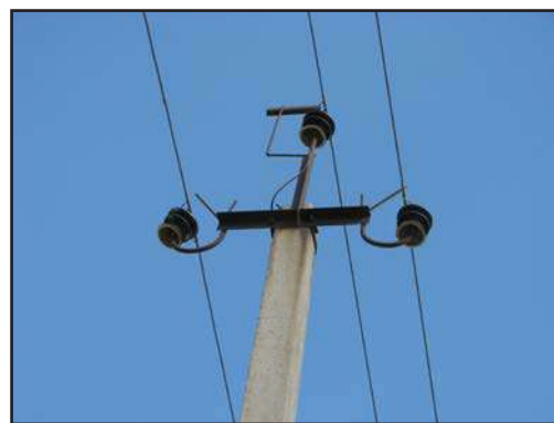
Рис. 4. ВЛЭП с траверсами, оснащёнными «усами» и присадой – наиболее опасные для птиц – получили название «ЛЭП-убийцы».
