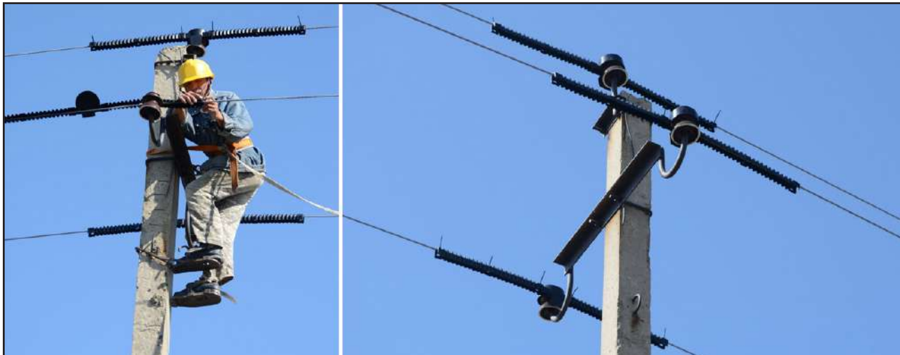
Оснащение птицеопасного участка ЛЭП ПЗУ (слева) и траверса птицеопасного участка ЛЭП, оснащённая ПЗУ (справа). Фото В. Вороновой. Equipping power lines by special plastic guards (left) and pole of dangerous site of power lines equipped by a special plastic guard (right). Photos by V. Voronova.
